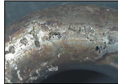
Particolare corroso e documentazione micrografica a corredo dell'indagine failuire
