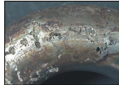
Particolare corrosivo e documentazione micrografica a corredo dell' indagine failuire
